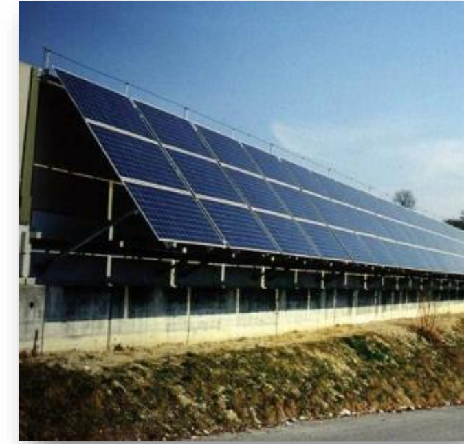
Installations photovoltaïques sur parois anti-bruit
