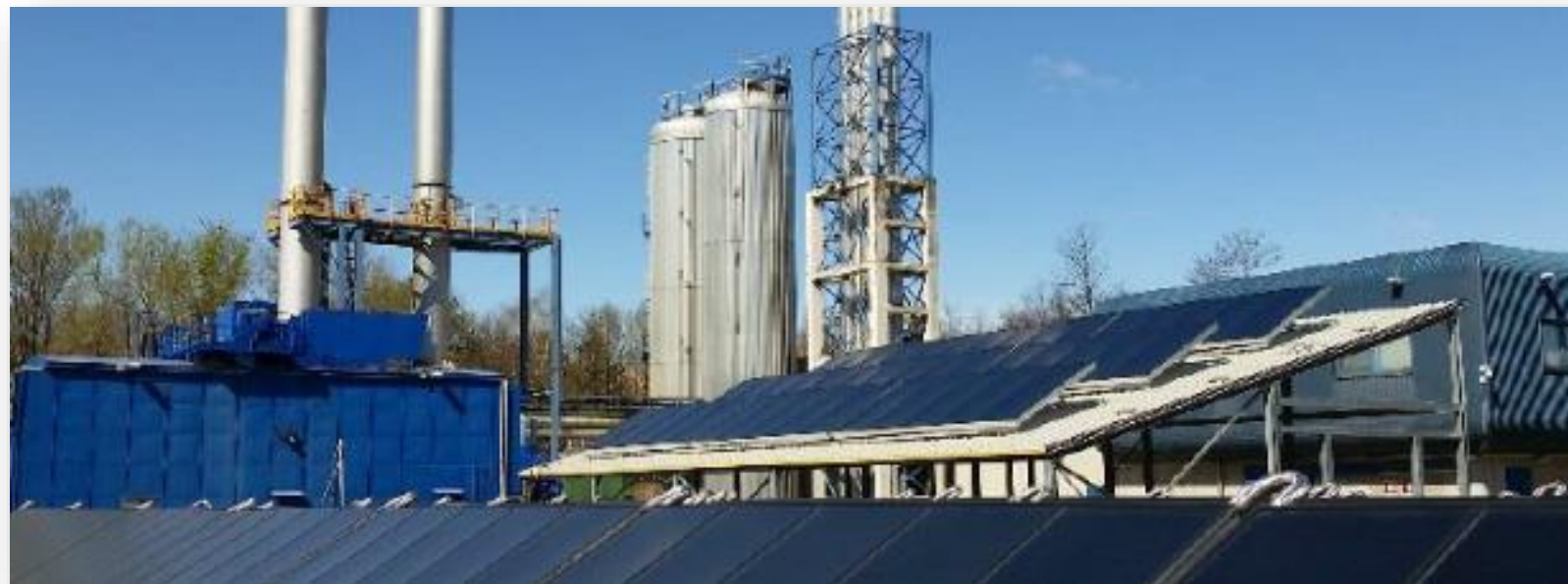
Panneaux solaires thermique industriel
