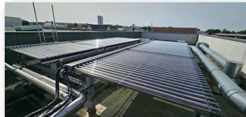
Panneaux solaires thermique
